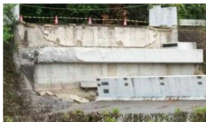
写真-2 横変位拘束構造の破壊、落橋(県道小川嘉島線・府領第一橋)
