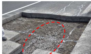
路盤の損傷の例 (路盤の細粒分がポンピングにより流失し、砕石が集まっている状況)
