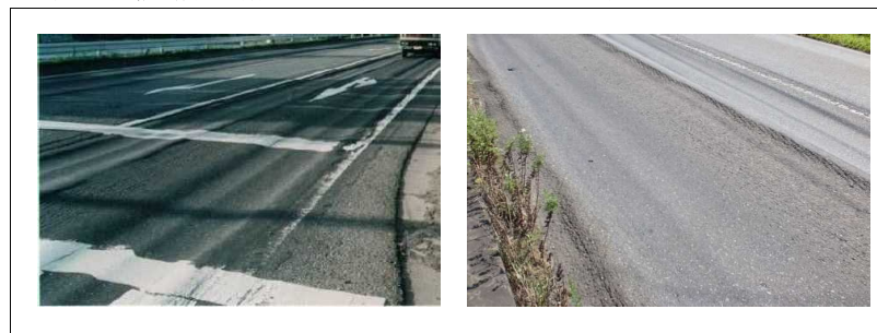
診断区分Ⅲ（修繕段階）：損傷レベル大（わだち掘れ量40mm程度以上）
