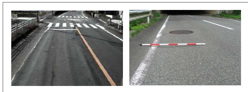
診断区分Ⅱ（表層機能保持段階）：損傷レベル中（わだち掘れ量20～40mm程度）
