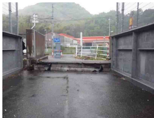
写真-4 舗装段差
