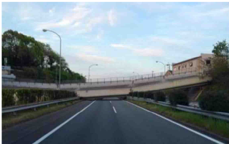
写真-1 落橋の状況
