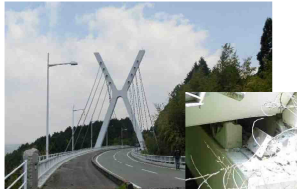
写真-6 支承部の損傷 (桑鶴大橋)
