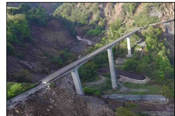
写真-8 橋台の損傷 (阿蘇長陽大橋)
