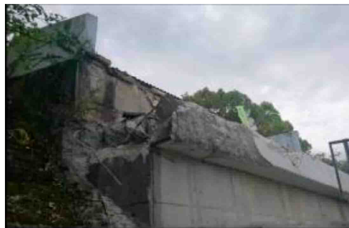
写真-3 横変位拘束構造の破壊
