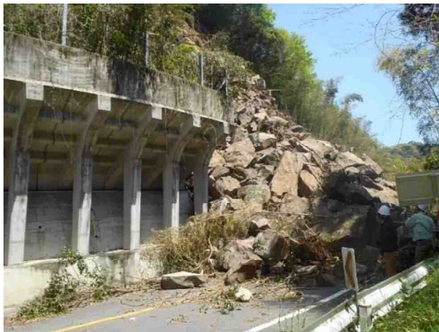
写真-11 落石・岩盤崩壊により全面的に通行止め (国道445号熊本県御船町内)
