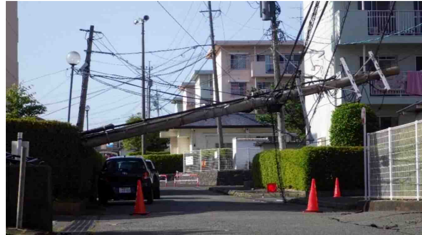
写真-12 電柱の倒壊 (町道・熊本県益城町宮園地先)
