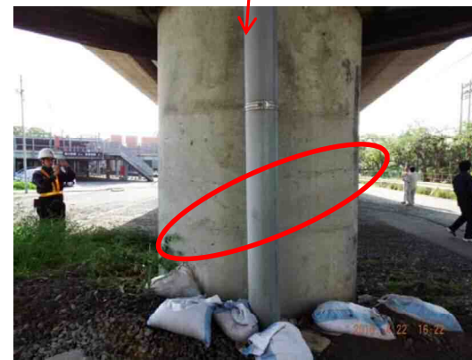
写真-2 曲げせん断ひび割れ
