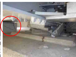
写真-6 支承の破損の状況
