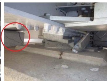
写真-6 支承の破損の状況
