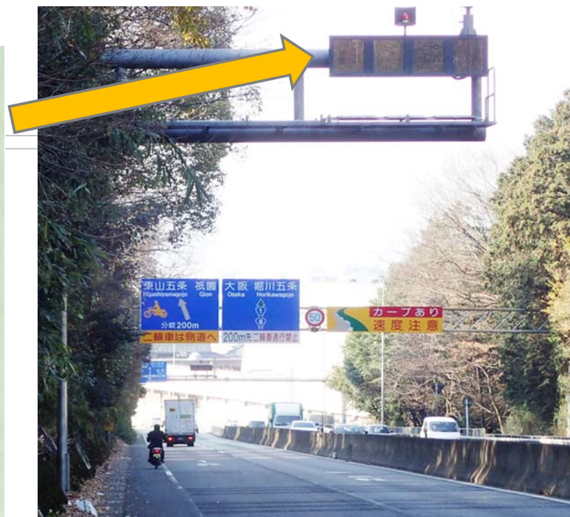
京都市東山区 国道1号 東山トンネル京都側 平成11年度導入
