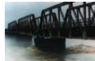
昭和56年7月洪水[梅雨前線] 高屋橋の橋脚が深掘れのため傾いた
