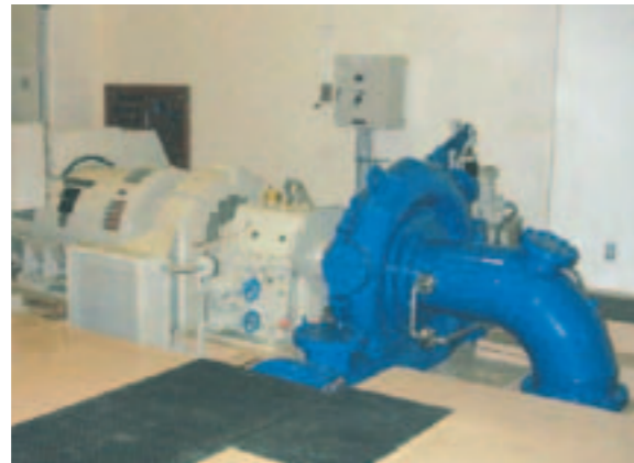
真名川ダム管理用水力発電設備
