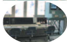
九頭竜ダム管理支所 操作室
