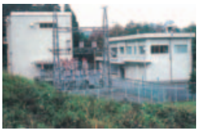
真名川発電所
