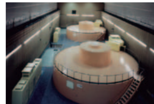
地下の水力発電施設
