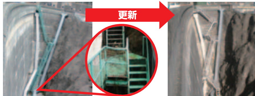
施設の更新例:老朽化により変形したキャットウォーク(管理用通路)を取替
