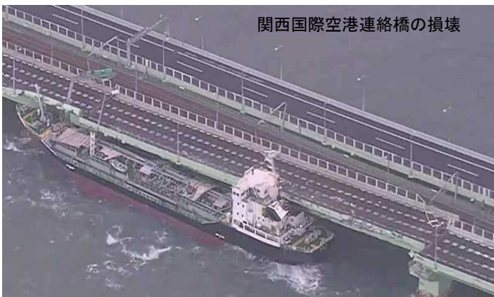
2018年9月 台風第21号による風被害
