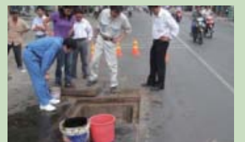
ホーチミン市での流量計(配水管)の確認 提供：大阪市
