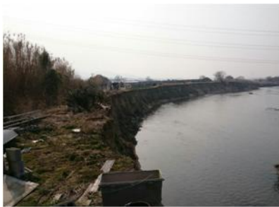
堤防崩壊危機の説明(現場の状況)
