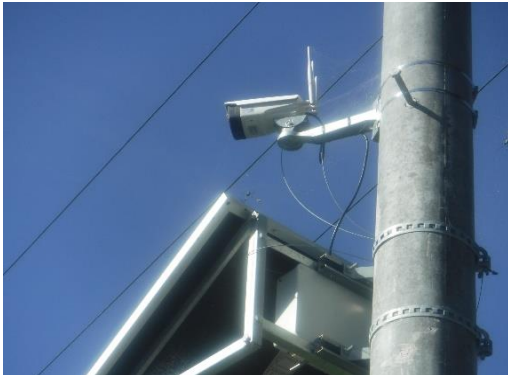
簡易型河川監視カメラ設置状況
