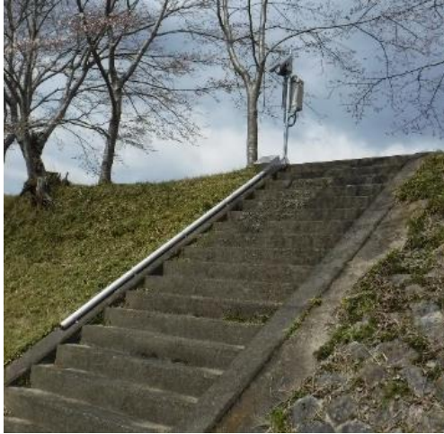
危機管理型水位計設置状況
