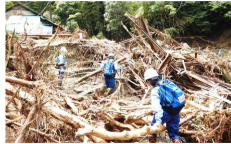
公共土木施設の被害状況の調査
