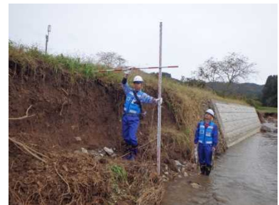
護岸の被災状況調査 (令和元年台風19号)
