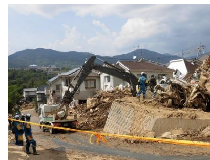
② 損壊した家屋等の解体、がれきの収集・運搬及び処分
