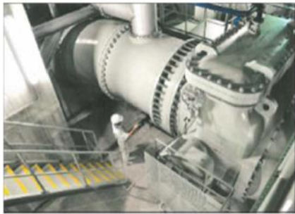
雨水ポンプの整備
