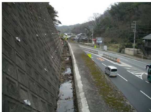
左写真の沢からの表流水は、擁壁頭部の縦断方向の水路に流されるが、一部が破損し、擁壁背面へ漏水している。その一部は擁壁の前面から湧水している。 擁壁本体の変状は特に認められない。 「漏水・漏水跡→Y」, 「湧水・湧水跡→Y」
