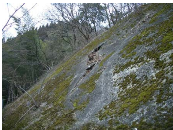
法面は、モルタル吹付け工でほぼ全面保護されているが、老朽化が著しく、各所にひび割れ、段差が認められる。 「法面工のひびわれ→Y」, 「法面工の段差→Y」
