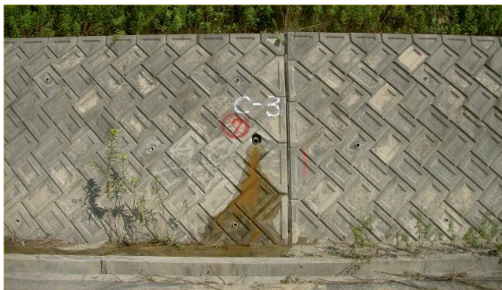
水抜きボーリング孔から濁り水が流出している
