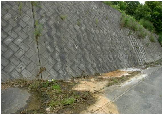
細粒化した盛土材の一部が流出した状況
