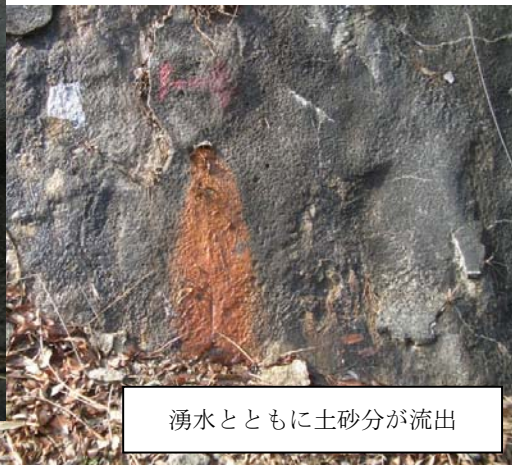
湧水の凍結による吹付け工の劣化
