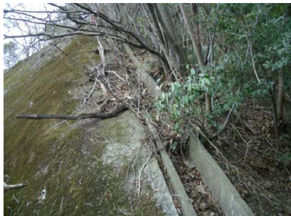
小段側溝、および法肩側溝には、倒木等が充填し、木の根で破損している部分もある。 「法面排水溝の段差・破損→Y」, 「法面排水工への土砂等の堆積→Y」
