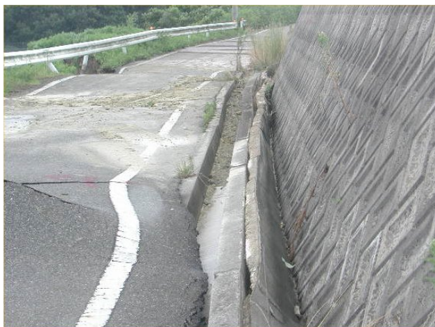
路面の盛り上がりと横方向への移動、側溝の圧縮など
