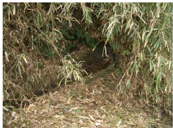
横断管渠呑み口部は、土砂や落ち葉が堆積し、一部通水を阻害している。横断管には特に変状は認められない。 「呑み口部の堆積物→Y」
