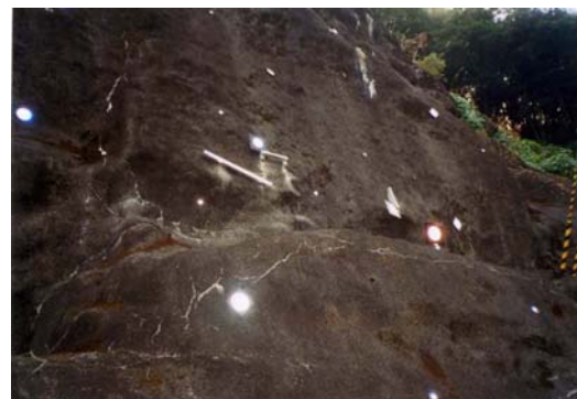
法面に設置された計測点（ターゲット）
