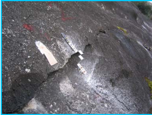
計測ピンを使用した亀裂幅計測
