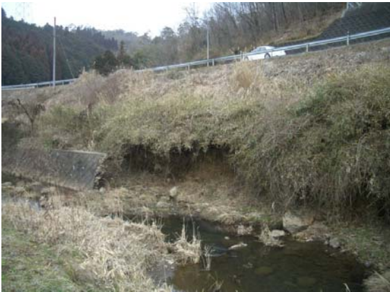
盛土法尻部が水衝部であり、護岸擁壁が崩れて盛土の基礎地盤部分が崩壊している。盛土および盛土擁壁部にまで崩壊が進行する可能性が有る。 「水衝部→Y」, 「波浪の影響の有無→Y」, 「脆弱化しやすい地質→Y」, 「擁壁基礎部の洗掘→Y」
