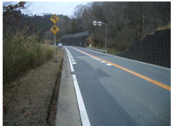
切土盛土境界付近から盛土側に若干沈下が認められる。舗装面にオーバーレイ跡がみえる(手前の補修跡は埋設跡であり評価外)。側溝に水流を阻害する堆積物がある。 「沈下→Y」, 「舗装の補修跡→Y」, 「側溝への土砂堆積→Y」
