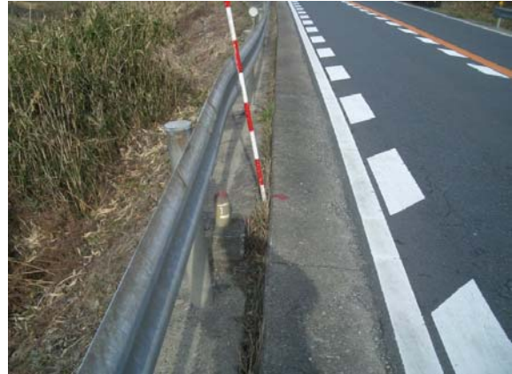
盛土路肩部(ガードレール基礎部を含む)が、亀裂を生じ、沈下も認められる。ただし、これまでの簡易計測ではあまり進行は認められていない。 「表層崩壊→Y」
