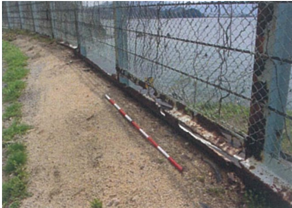
落石防護柵や網の腐食
