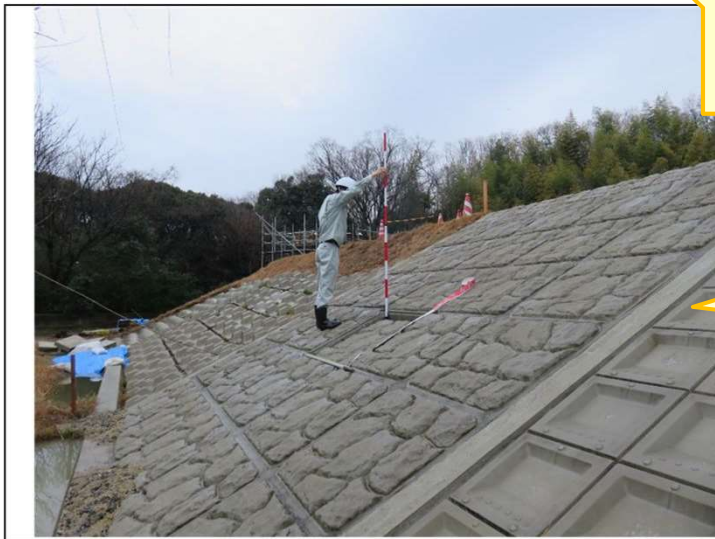
陥没および空洞化発生箇所全景
