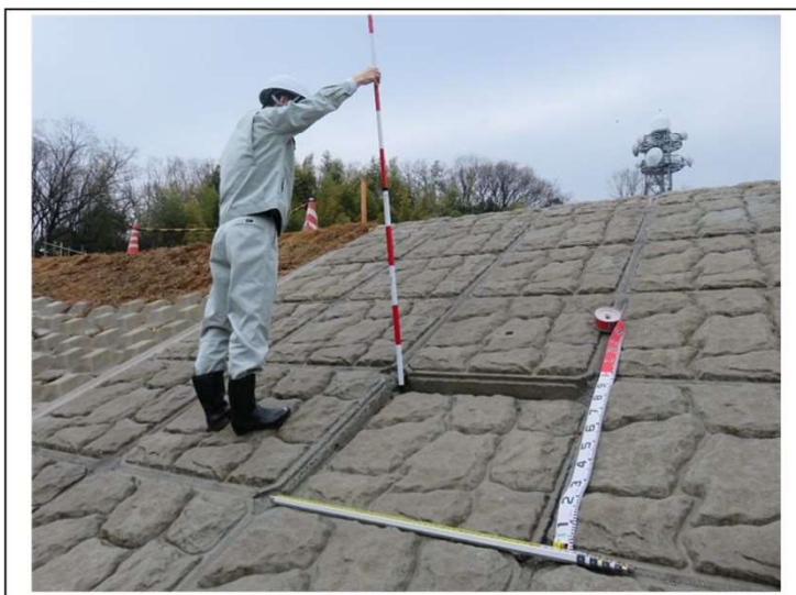
ブロック陥没状況
