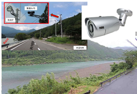
図-5 河川監視カメラの設置
