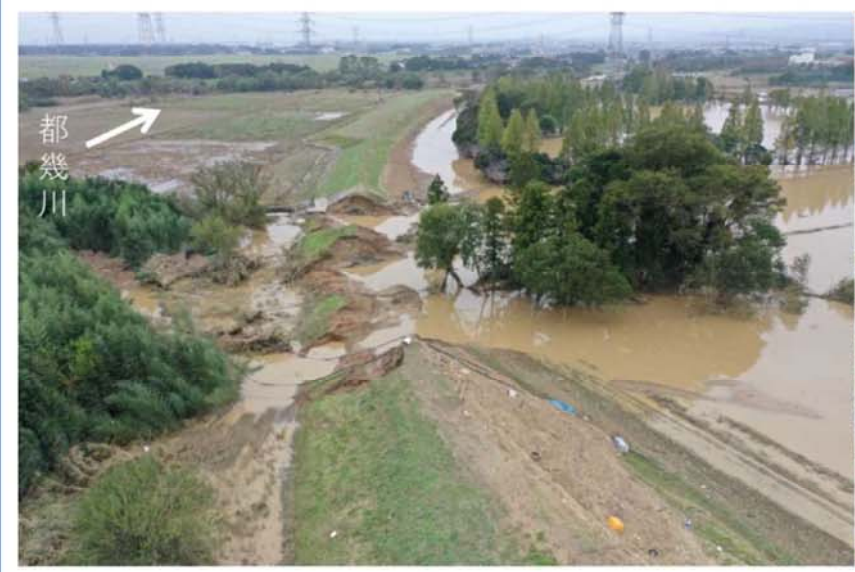
都幾川0.4k右岸 決壊箇所
