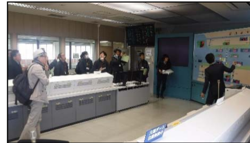
毛馬排水機場
