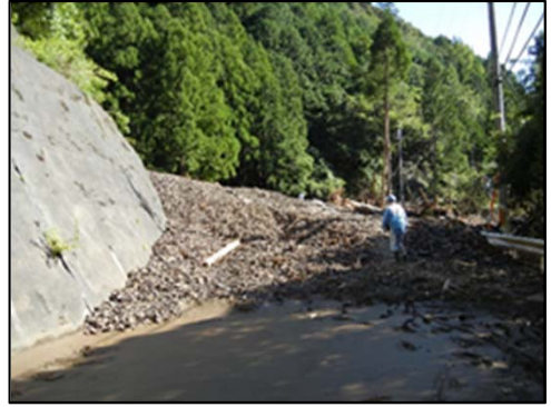
国道425号線の土砂流出状況
