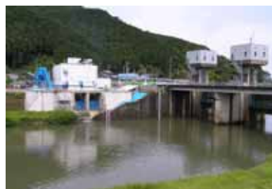
写真10 相野谷川排水機場
