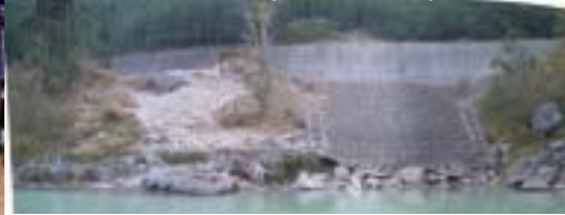
台風11号出水(北山川河岸洗掘 三重県紀和町)
