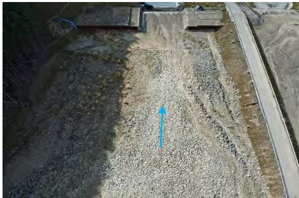
写真No.9 堰堤堆砂状況
