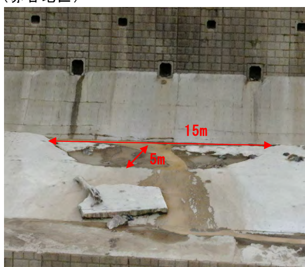
(c) 2号堰堤 水叩き（洗掘）拡大正面
