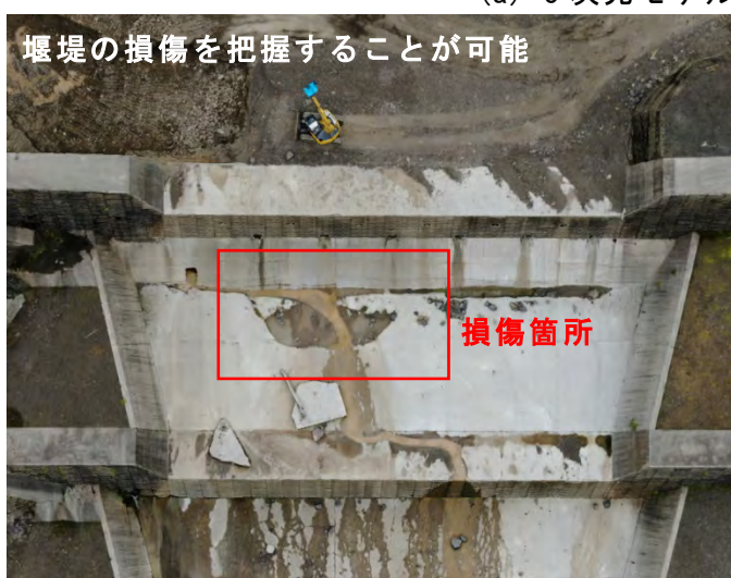
(b) 2号堰堤 水叩き（洗掘）拡大平面
