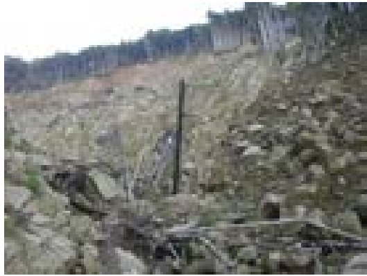
熊野酸性岩(硬質だが亀裂多い)と金山谷川の崩壊地
