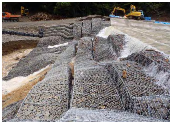
下流端の護床工沈下状況（栗平地区）
