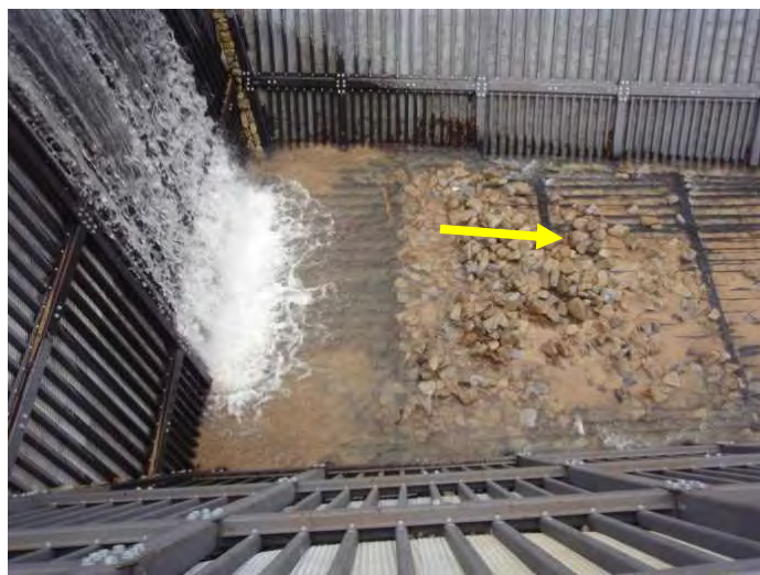
床固工直下での洗掘（熊野地区）
