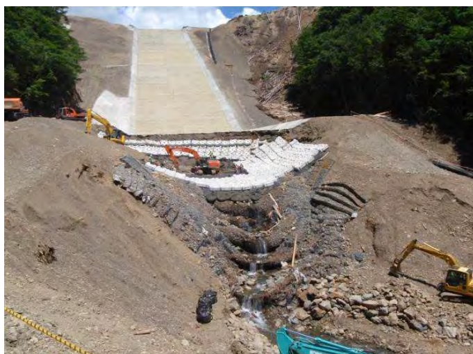
仮排水路下流端の洗掘状況（栗平地区）
