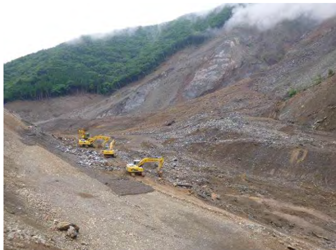
仮排水路の埋没状況（赤谷地区）
