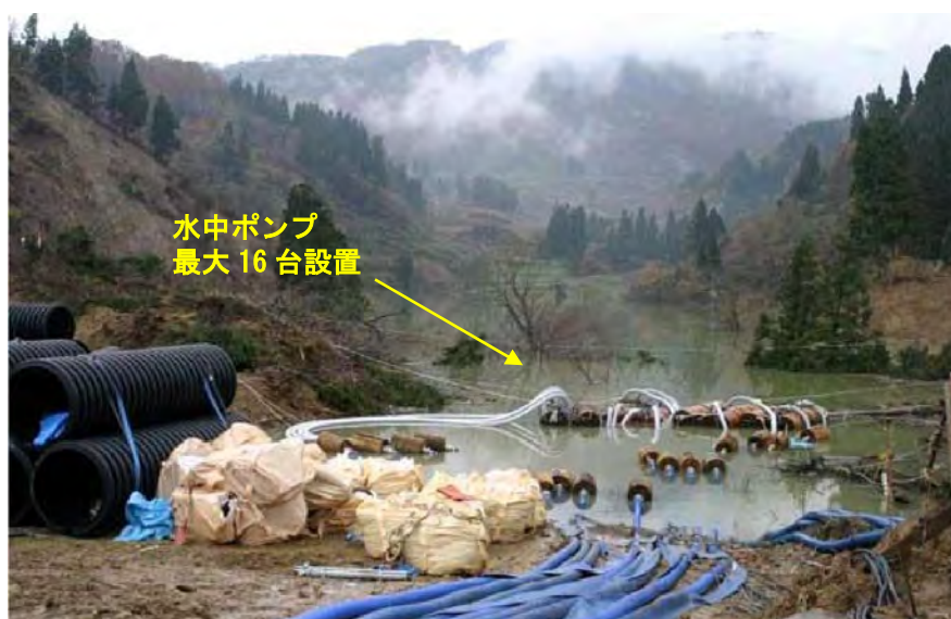
排水ポンプ設置例（寺野地区／中越地震）
