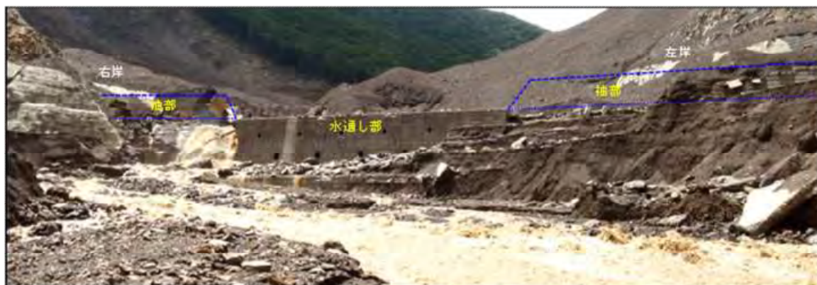
崩壊地からの土砂流出による砂防堰堤の破損状況（赤谷地区）
