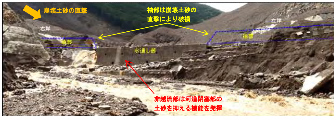
崩壊土砂の直撃により袖部は破損したものの、非越流部が機能を発揮した事例 (平成 26 年台風 11 号時の赤谷地区の 2 号砂防堰堤)
