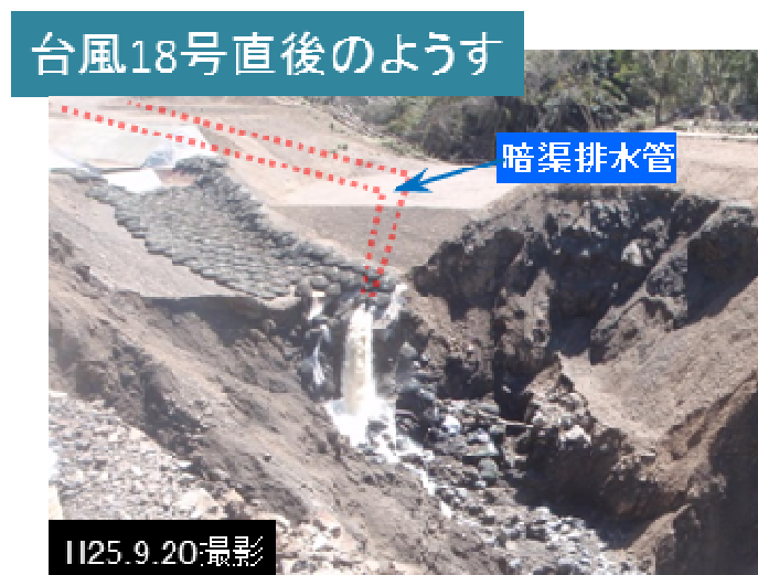
暗渠排水管下流端での洗掘状況（栗平地区）
