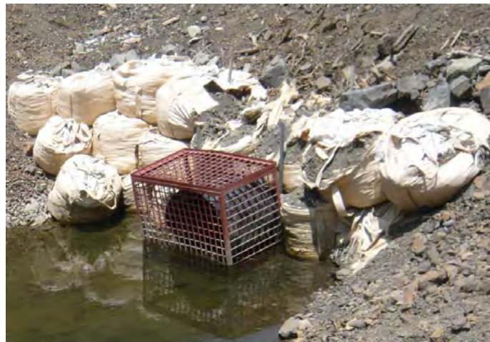
補強前の暗渠排水管の呑口部（赤谷地区）
