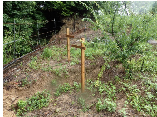
写真-1 斜面頂部での変状 (立平地区)
