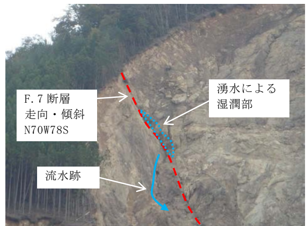
写真-2 崩壊斜面の断層とその周辺の状況。撮影日は2019年10月28日である。断層周辺で地下水の湧出が見られる。
