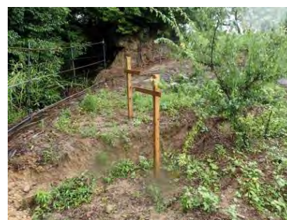
写真-2 斜面頂部の変状
