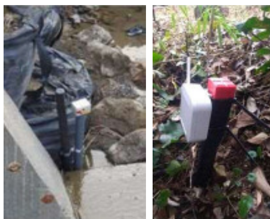
図 3 水位計ならびに傾斜計設置例
