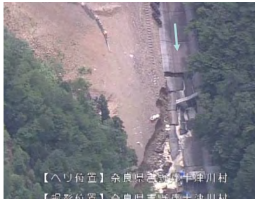
平成 27 年台風 11 号時の仮排水路工破損状況
