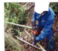
事故写真 事故状況 竹切断後 公園外見部
