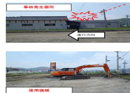
事故状況写真②
