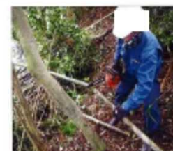
事故写真 事故状況 竹を切断する様子 公園外見部
