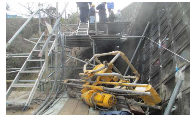
【被災状況写真】
