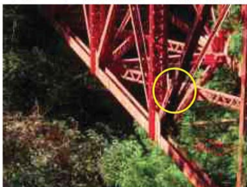
平成27年 定期点検 Ⅲ判定（腐食）
