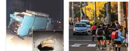
下水道の老朽化による道路陥没
