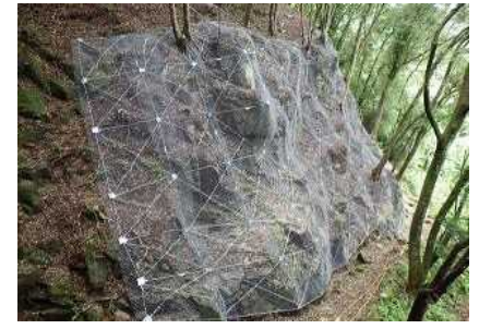
落石防護ネット
