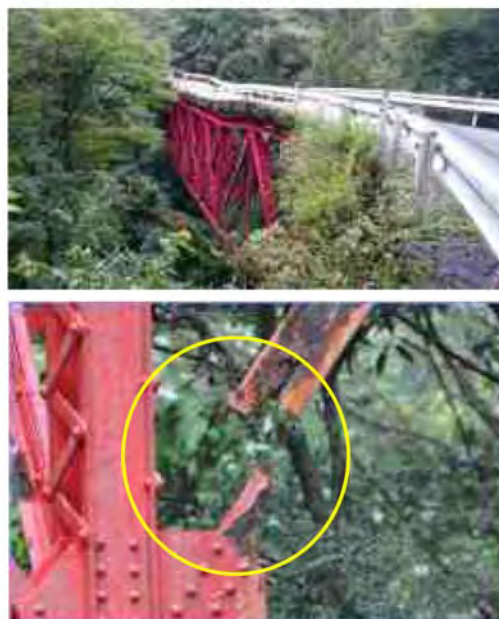
平成28年(点検から7か月後) 斜材4ヶ所の破断を発見
