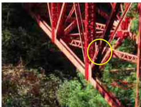
平成27年 定期点検 Ⅲ判定(腐食)
