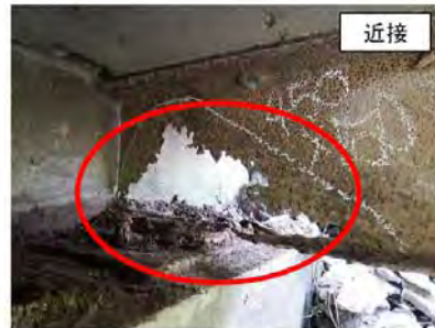
近接目視により断面欠損を確認
