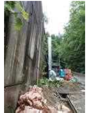
写真 壁面の傾斜の例
