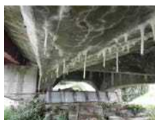
主桁のひびわれ
