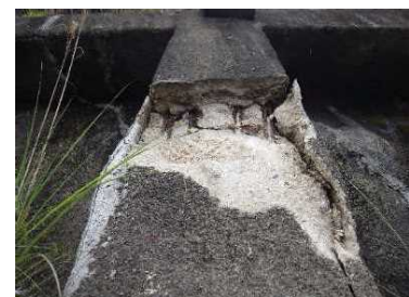
法砕工の老朽化損傷
