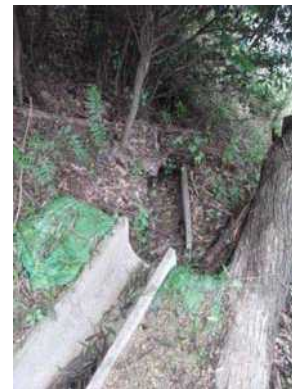
写真 排水溝の破損の例
