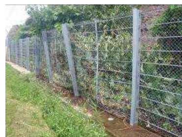
写真 落石防護柵の傾動の例
