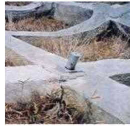
写真 受圧構造物の破損の例
