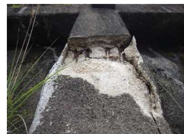
法砕工の老朽化損傷
