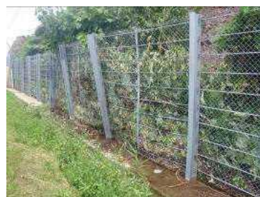
写真 落石防護柵の傾動の例
