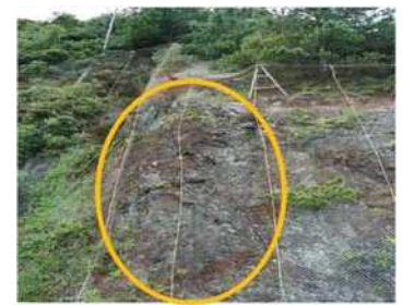
写真 落石防護網の著しい腐食による断面欠損の例
