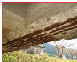
主桁の剥離、鉄筋露出
