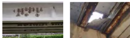
コンクリートの保護塗装後に剥離した例
