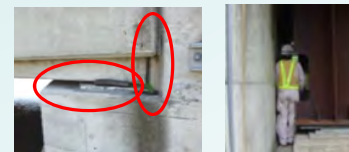
支保交換や桁端点検の空間なし
