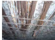
PC鋼材の腐食例
