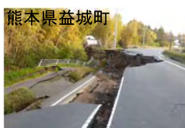
熊本県益城町 盛土の崩壊
