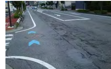
占用工事が起因する路面損傷
