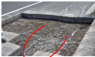
路盤の損傷の例 (路盤の細粒分がポンピングにより流失し、砕石が集まっている状況)
