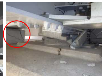
写真-6 支承の破損の状況
