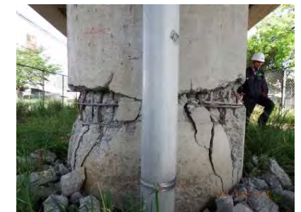
写真-7 段落し部の損傷 ちゅうおうせんりつきょう 市道(1-3)中央線・中央線陸橋
