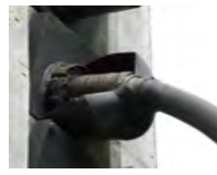
ケーブル損傷例
