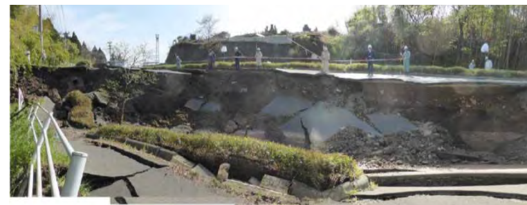
路面陥没地付近の状況 (4月15日)
