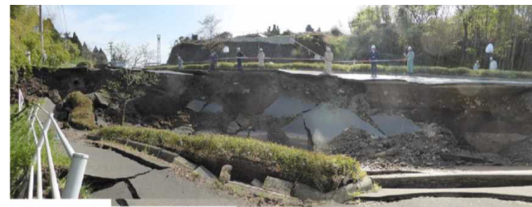
路面陥没地付近の状況（4月15日）
