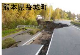
熊本県益城町 盛土の崩壊
