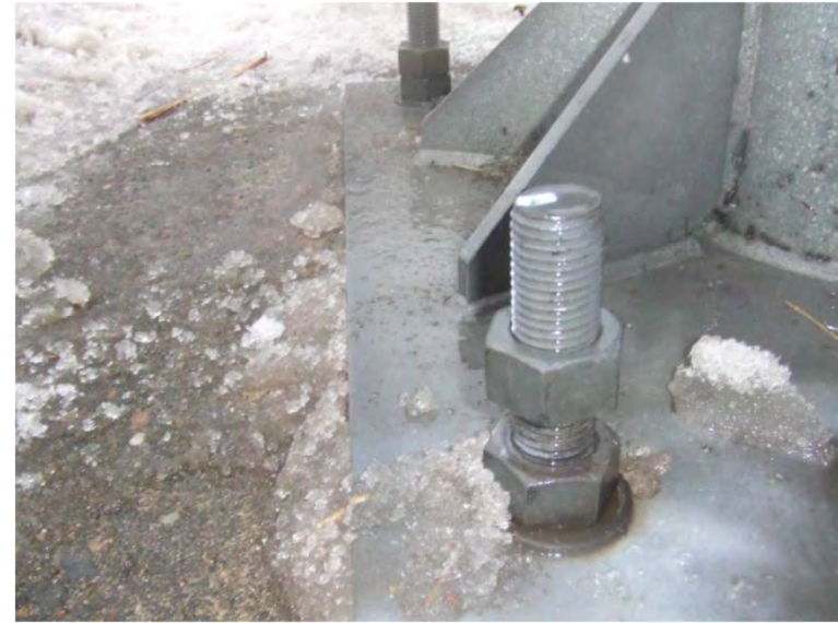
ボルトの緩み (施工不良)
