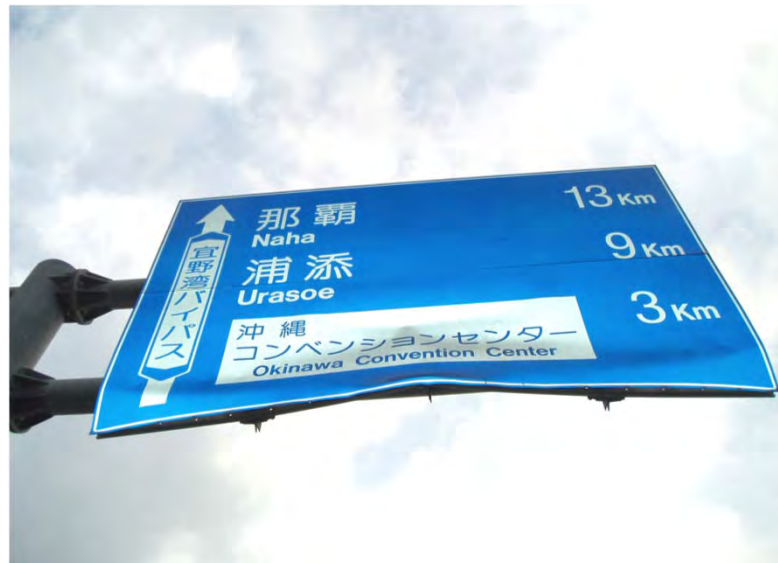
異常変形 (車両衝突)
