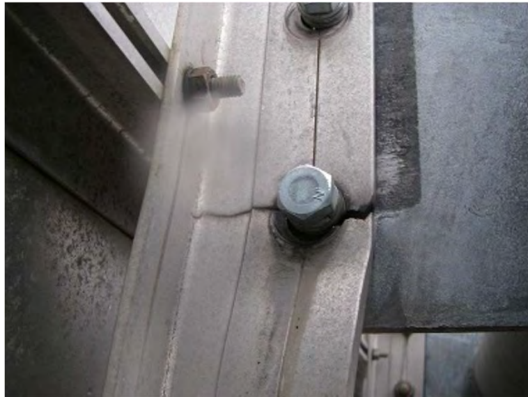
き裂損傷 (車両衝突)
