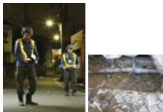
道路下の漏水調査 発見した漏水(給水管)
