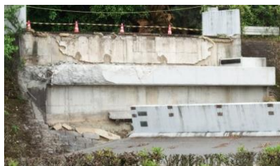
写真-2 横変位拘束構造の破壊、落橋(県道小川嘉島線・府領第一橋)
