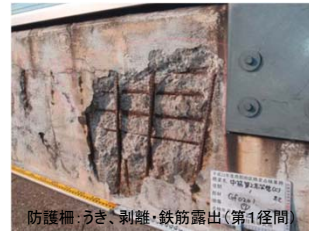
防護柵:うき、剥離・鉄筋露出(第1径間)
