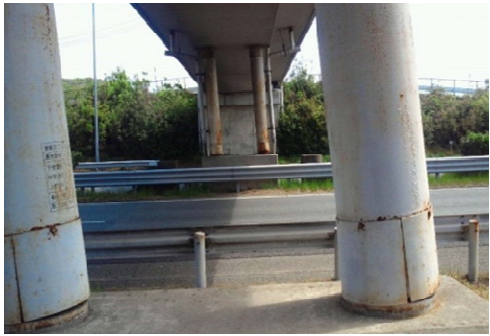
平成28年4月16日 13時 被災後の状況
