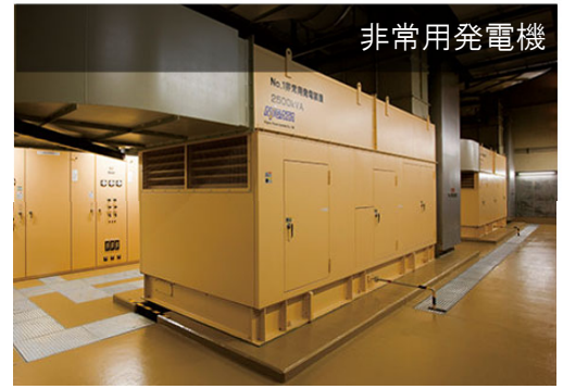
非常用発電機 画像提供: 三菱地所株
