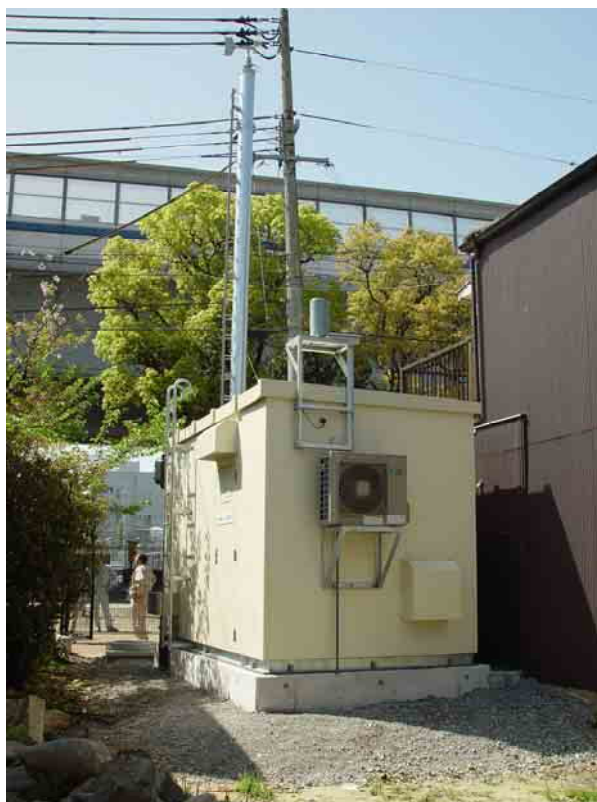
写真15 大気常時観測局の設置状況（芦屋市・神戸市）
