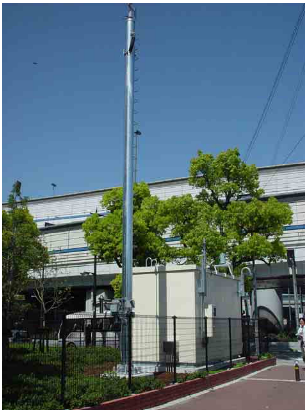
西宮市 西宮インター交差点局(平成14年度設置・交差点南西側)
