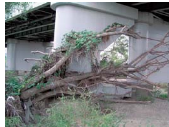
洪水の流木（加古川 5.5k 付近）
