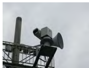
河川監視カメラ（CCTV）
