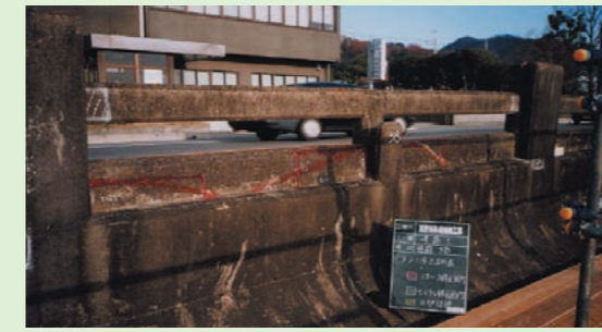
1.崩れて畳を挿入できない箇所や鉄筋が露出している危険な箇所をチェック
