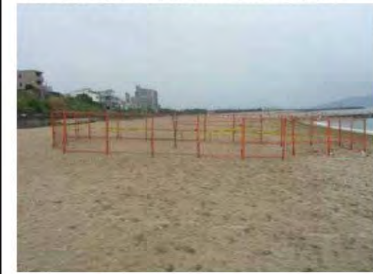
人孔構造物【暗渠】周辺で陥没を確認
