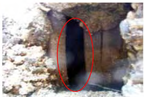
管渠接合部の隙間からの吸出
